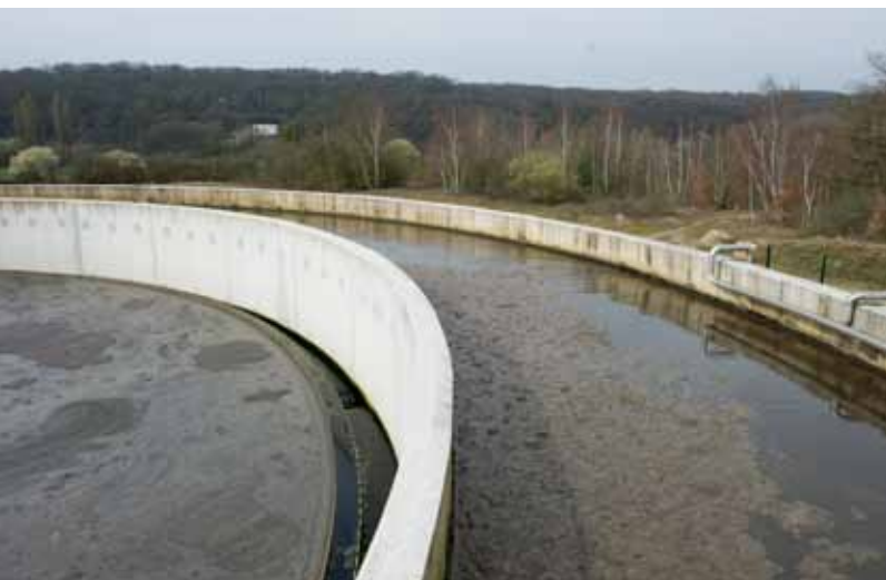
Bassin de décantation et de traitement des eaux usées
