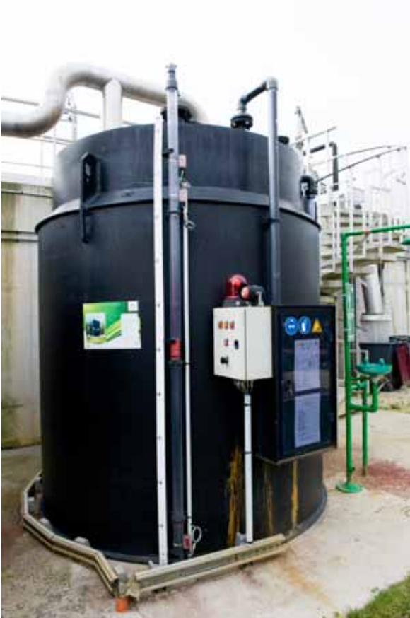
Cuve pour traitement du phosphore
